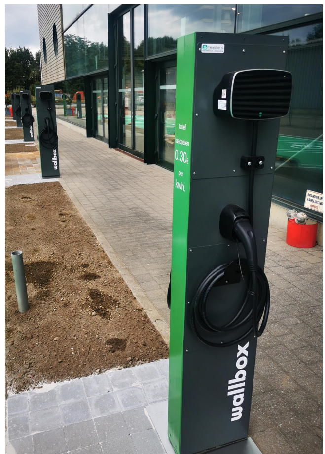
Chargeur Wallbox installé dans le parking de Thomas Home & Garden Inspiration
