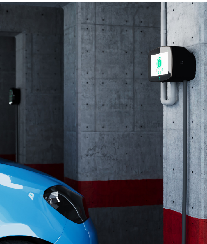
Cargadores Commander 2 instalados en el aparcamiento.
